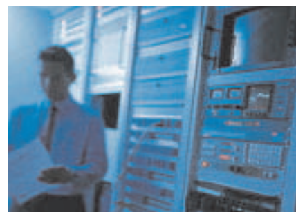
Server, Datenspeicher und Netzwerkkomponenten.
