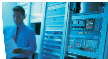
Integración en los racks de alta densidad.
