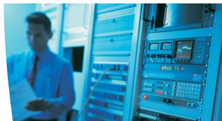
Integração em racks de alta densidade.
