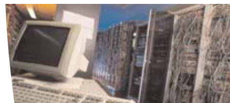
Integración en racks de alta densidad.
