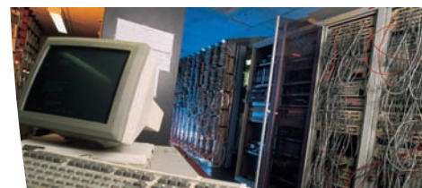
Integração em racks de alta densidade.
